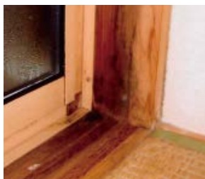
室内への雨漏り
